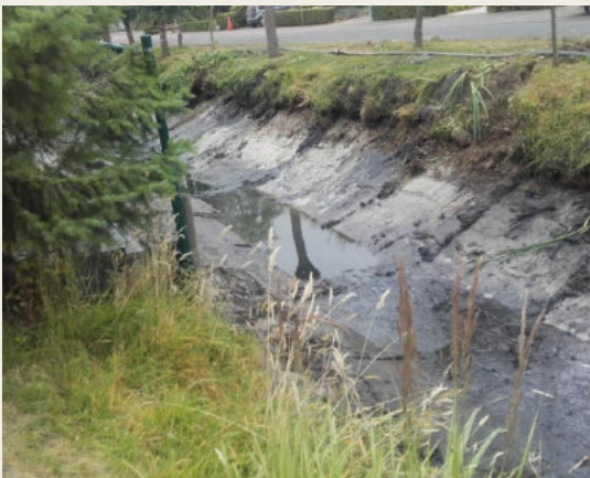
Fig 109. Het volledige aangetaste gebied werd uitgebaggerd. Foto: Provincie Oost-Vlaanderen dienst Integraal Waterbeleid
