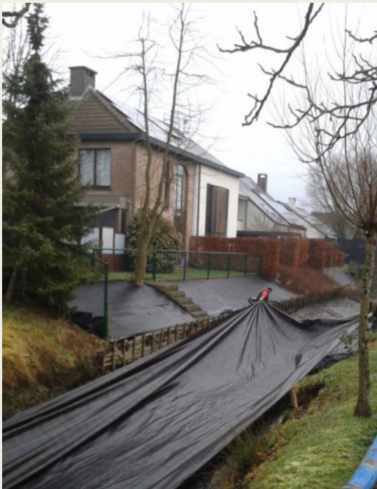
Fig 111. Er werd een lichtwerende afdekking van geotextiel aangebracht om de vegetatie samen te drukken en het zonlicht een paar jaar af te schermen . Foto: Provincie Oost-Vlaanderen dienst Integraal Waterbeleid
